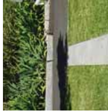
Wide concrete edge
