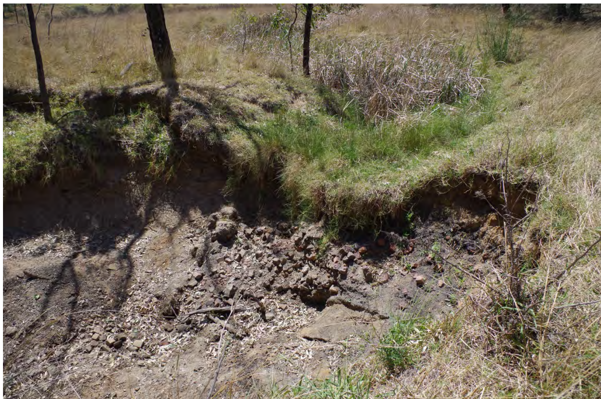
Chainage 10934 : Cut Back Erosion
