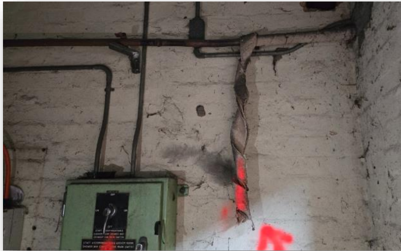
Example: Asbestos Rope
