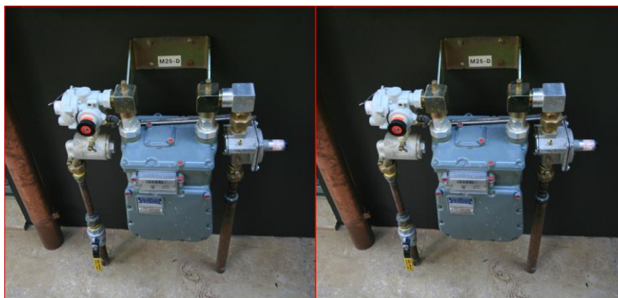
HSB Gas Meter
